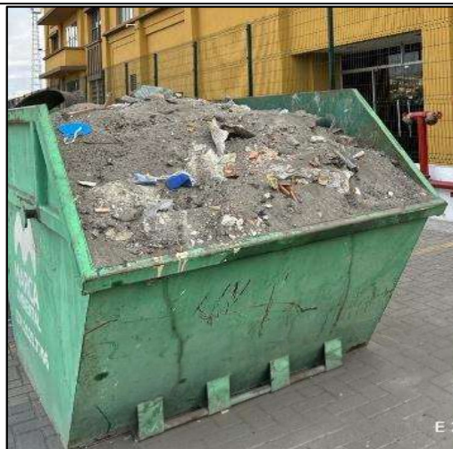
Figura 29: Resíduos de construção civil armazenados em caçamba brook
